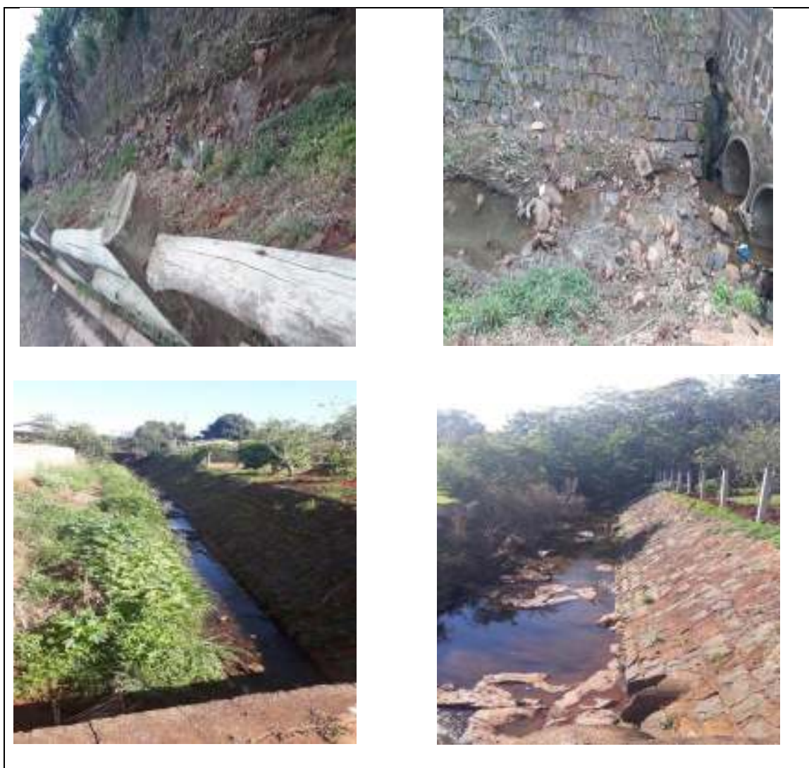
Figura 73: Principais tipologias de unidades operacionais implantadas em Boa Vista da Aparecida para o sistema de drenagem urbana.
