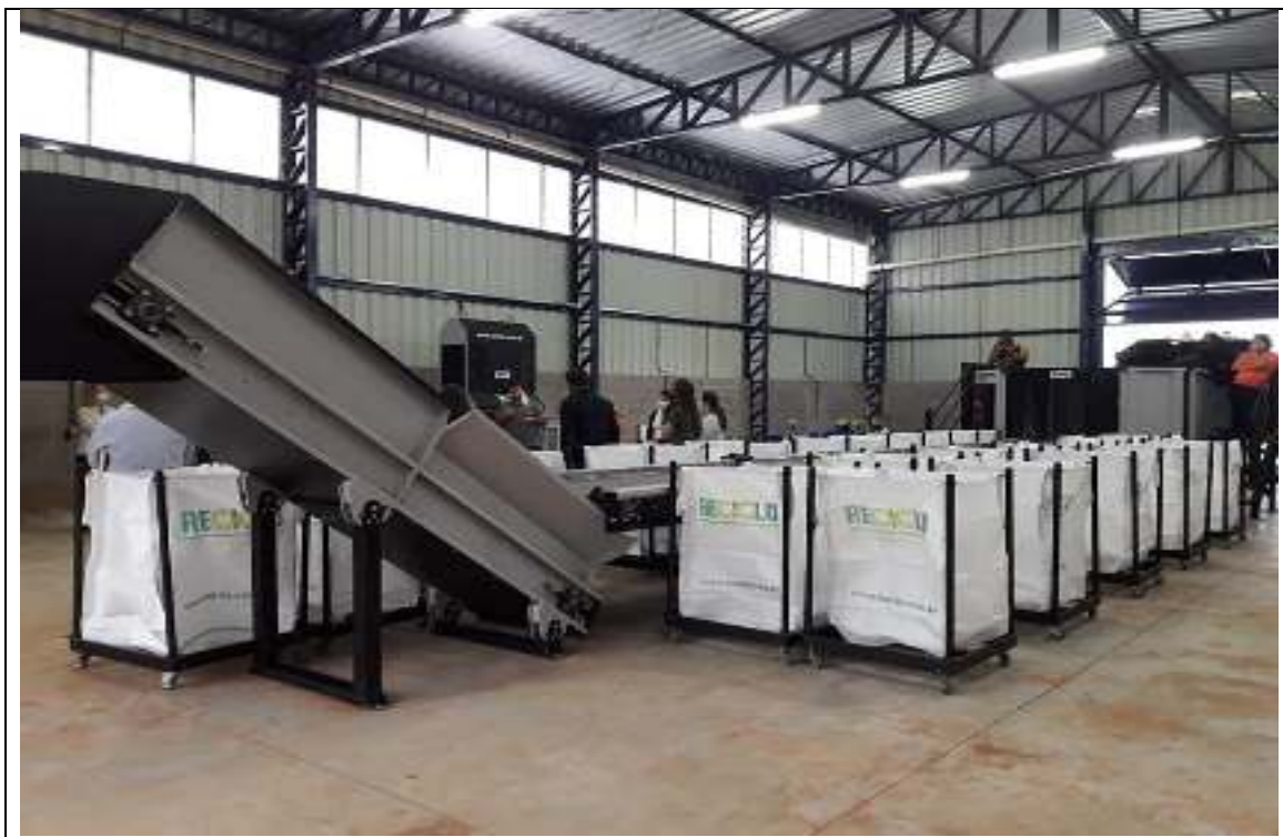
Figura 39: Equipamentos novos na nova UVR do município de Boa Vista da Aparecida/PR-2020.
